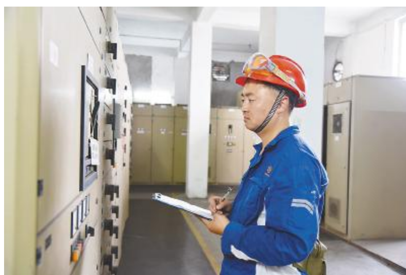
刘勋在配电室进行巡查
